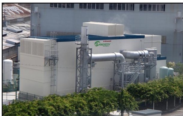
マツダが導入の検討を進めるガスコージェネレーションシステム(写真: 川崎重工業株式会社神戸工場パワーセンター3号)
