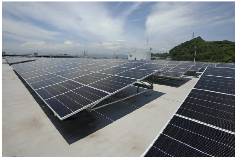
太陽光発電設備
